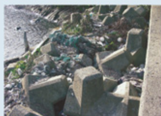
消波ブロックの目詰まり
