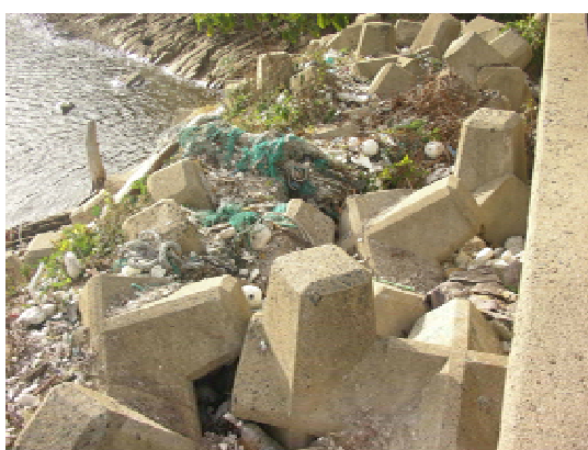
写真 4.2-9 ブロックの目詰まりにより消波機能の低下が懸念される消波工 (上県町伊奈の海岸に設置された消波工)
