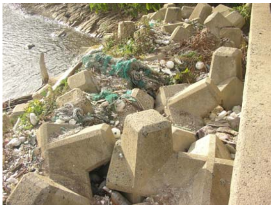
ブロックの目詰まりにより消波機能の低下が懸念される消波工
