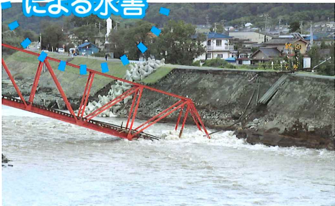
みず なが ちから 水が流れる力で堤防が崩れ、落ちてしまった上田電鉄の鉄橋
