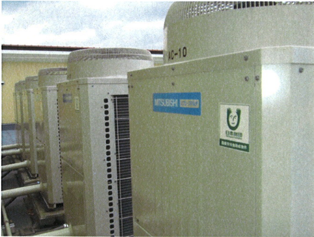
(特別養護老人ホーム屋上 室外機)
