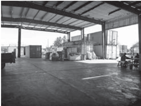
2006年の台風エステルにより側面壁と天井が露出したトランジット貨物倉庫
