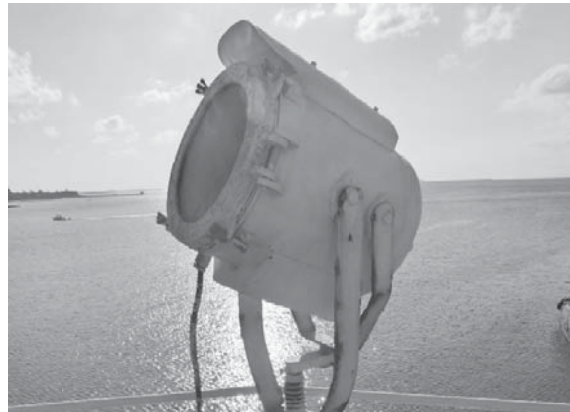
故障している照明器
