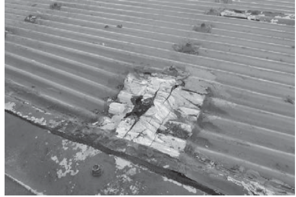
雨漏りする外甲板用屋根
