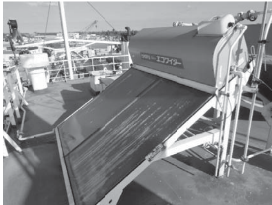
機能していないソーラパネル
