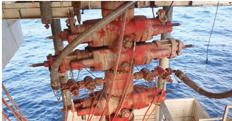
図 26 ジャッキアップリグ上の BOP スタック配置 [13]
