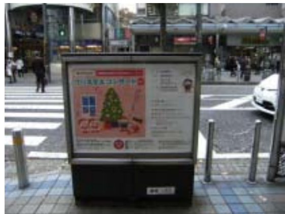
■歩道上のトランスを利用したサイン
