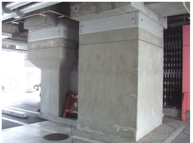
▲柱頭に設置された免震装置
