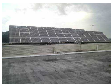
屋上「太陽光パネル」
