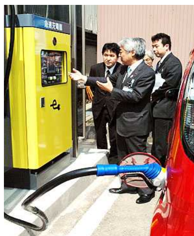
高岡市役所に設置されている急速充電施設
