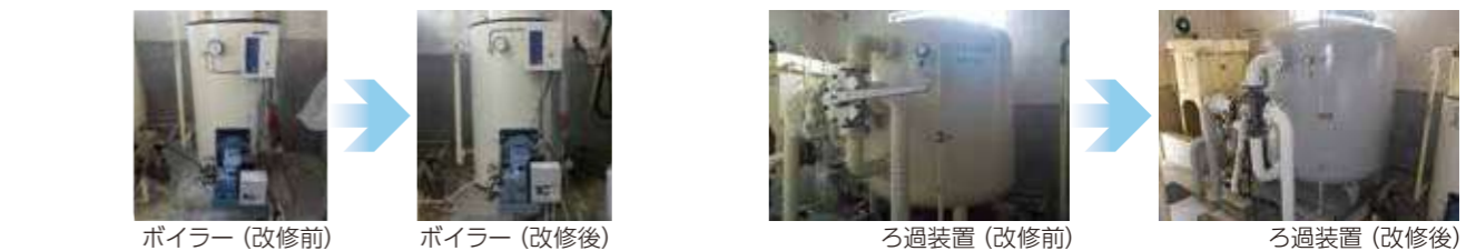
ボイラー(改修前)
