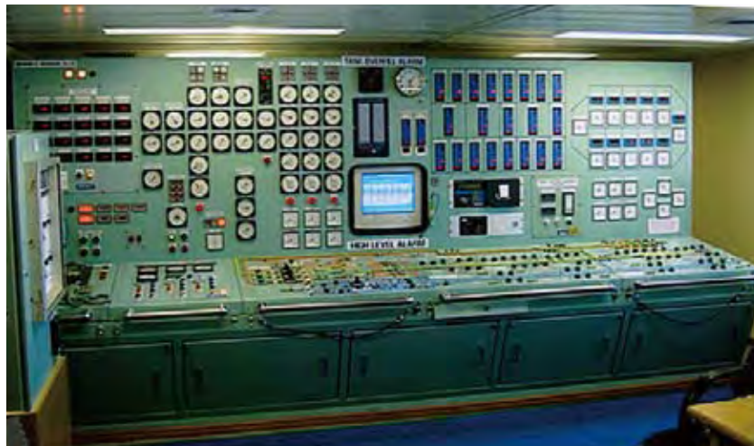
貨物油及びバラストの遠隔制御盤
