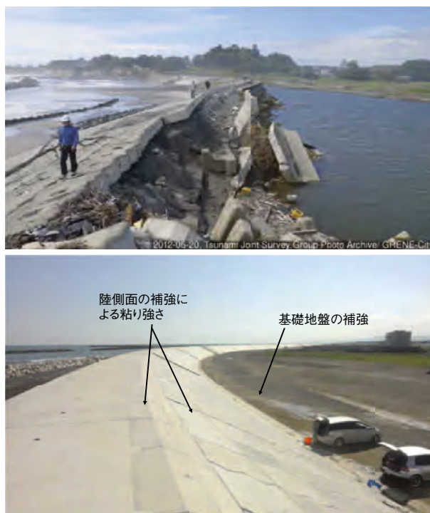
図5-3-3 上：典型的な海岸堤防の破壊（福島県相馬市） 下：復旧された海岸堤防（宮城県亶理町）
