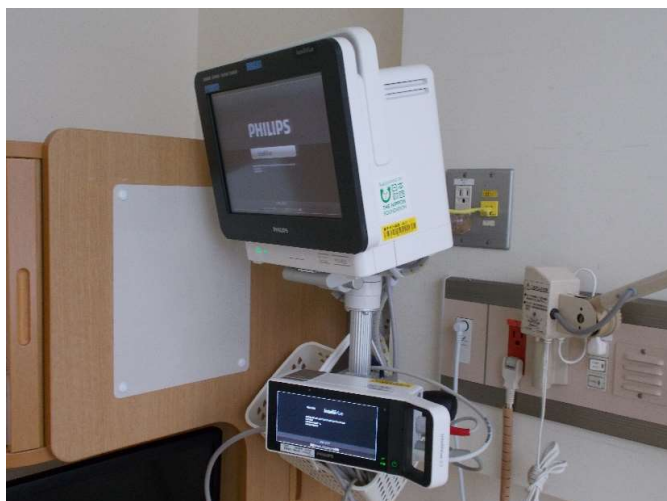
生体情報モニタを8病室に各1台設置
