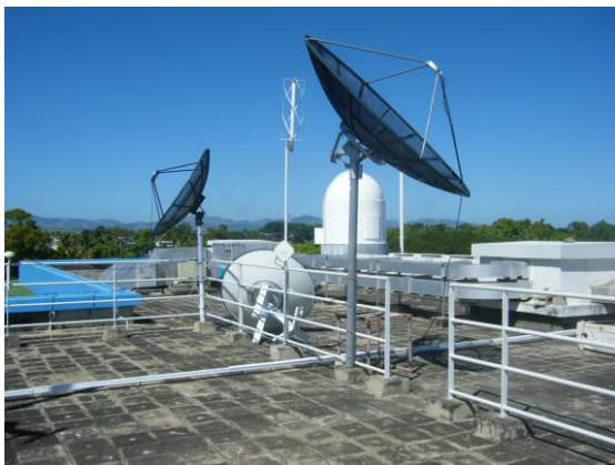
屋上に設置されたレーダー
