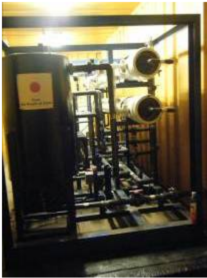
海水淡水化装置
