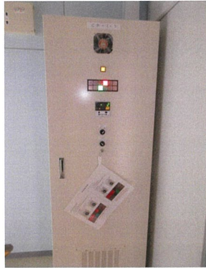
計装盤取付写真 (場所：シャワー脱衣室)
