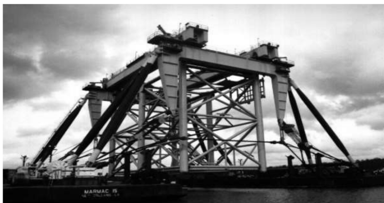
図 5-16 ジャケット・トップサイド吊り上げシステム（Versatruss Jacket Lifting System）
