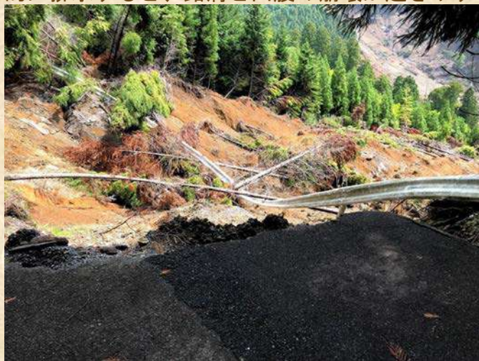
反対側から見た崩壊現場
