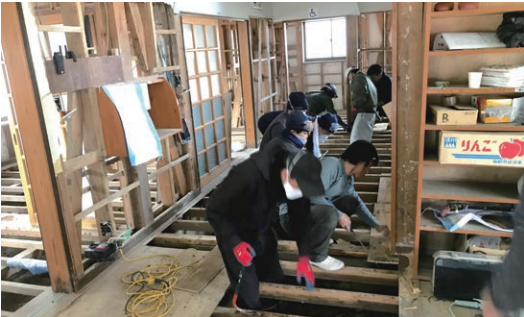
▲被災家屋の復旧活動
