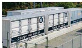
定置用蓄電システム例
