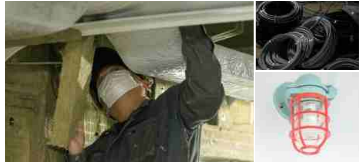
1.大きな満足感を味わえるのは、「イメージ通りに電線を配線できたとき」とある社員は話す 2.船の電気系統を支えている無数の電線 3.船内を明るく照らす光が、長い航海に挑む船員の心に束の間の安心感を与えている
