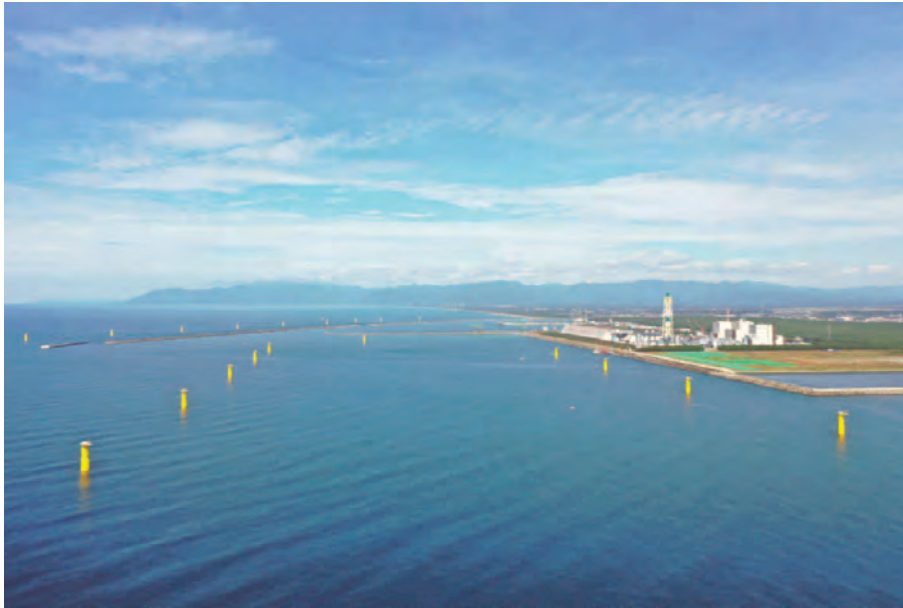
図1-2-2 基礎部分の杭の打設が完了した能代港（合計20か所） （出典：秋田洋上風力発電㈱）
