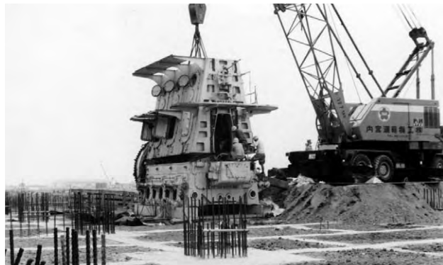
建設前に据付けられたUEディーゼルエンジン
