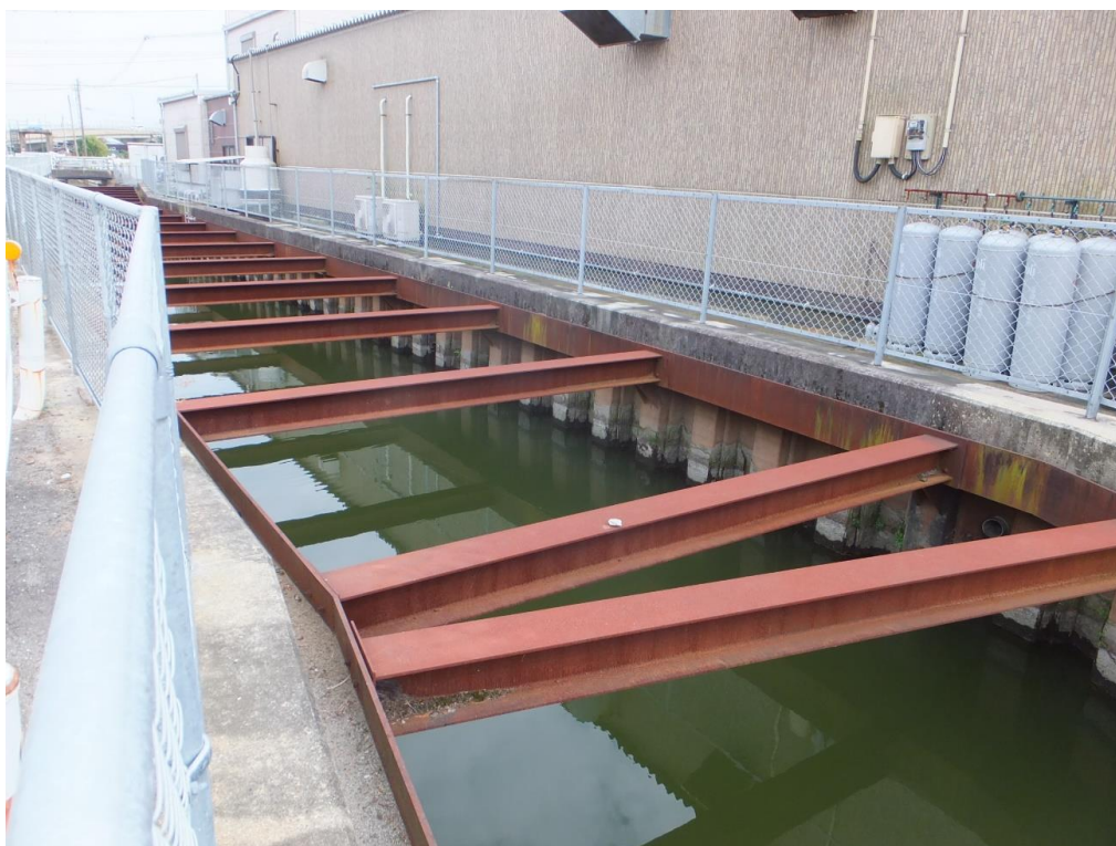
写真-7.2 町橋横の右岸側から落水場所と推定される H 型鋼の状況および上流方向（2021年 10 月 9 日）
