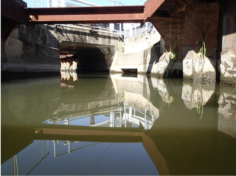
写真-7.4 落水場所の右岸側を上流側から。町橋方面と落水したと推定される H 型鋼 (2021 年 10 月 9 日)
