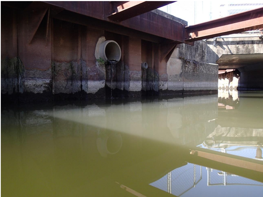
写真-7.5 落水場所左岸側を上流側から。左に町橋 (2021 年 10 月 9 日)
