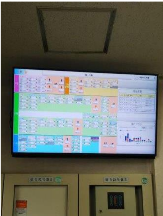
NSコール設備更新工事 (各階設置_一括管理モニター)
