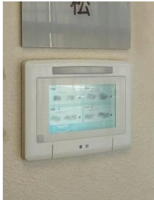
NSコール設備更新工事 (各居室表示板_連動表示)
