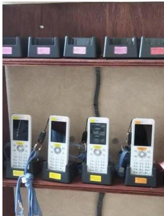
NS コール設備更新工事 (既存 PHS との連動)
