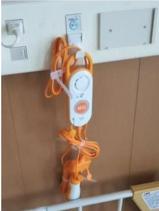
NS コール設備更新工事 (ベッドコール交換_センサー連動タイプ)
