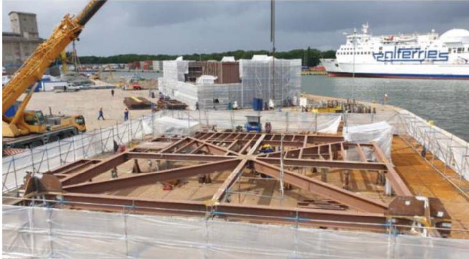
(写真) 旧 Lenin Shipyard で建造中の洋上変電施設のトップサイド
