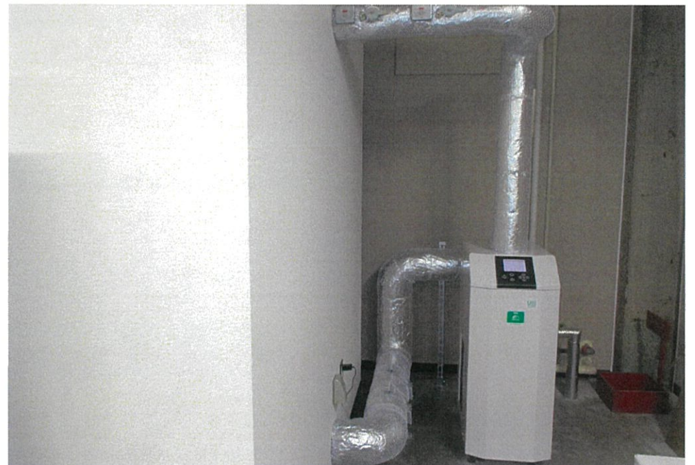
精密空調機(耐火保管庫用)
