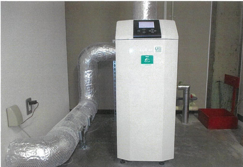
精密空調機(耐火保管庫用)
