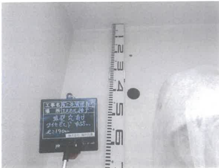
【工事種目】エスカル神戸洗濯給水配管 【施工内容1】屋上外部 【施工内容2】外壁ダイヤモンド貫通 【施工内容3】55mm貫通
