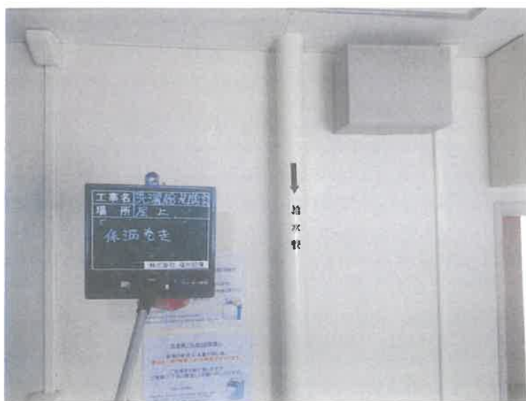
【工事種目】エスカル神戸洗濯給水配管 【施工内容1】5階洗濯室 【施工内容2】室内露出部 【施工内容3】グラスウール保温筒/合成樹脂製カバー
