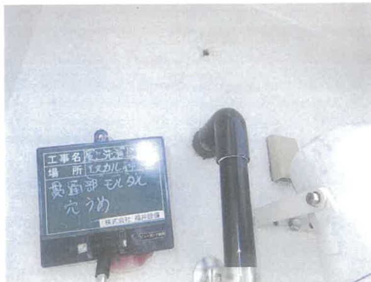
【工事種目】エスカル神戸洗濯給水配管 【施工内容 1】貫通部処理
