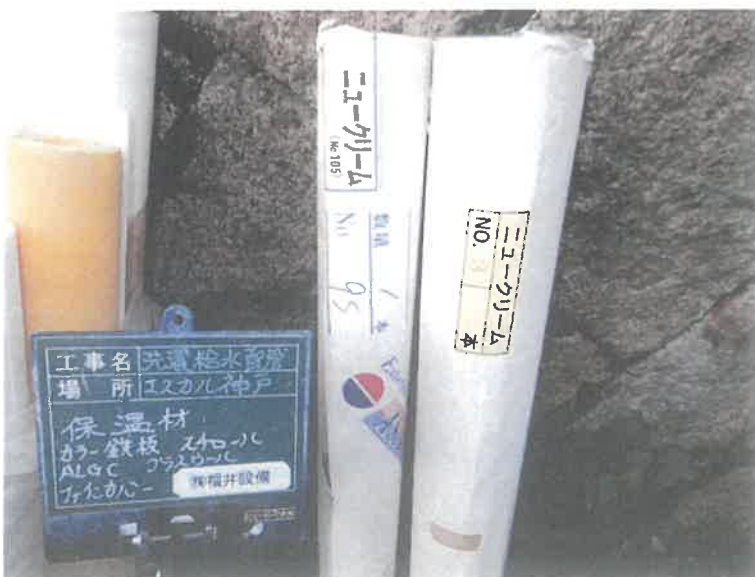
【工事種目】エスカル神戸洗濯給水配管 【施工内容1】5階洗濯室 【施工内容2】保温巻き工事 【施工内容3】保温材
