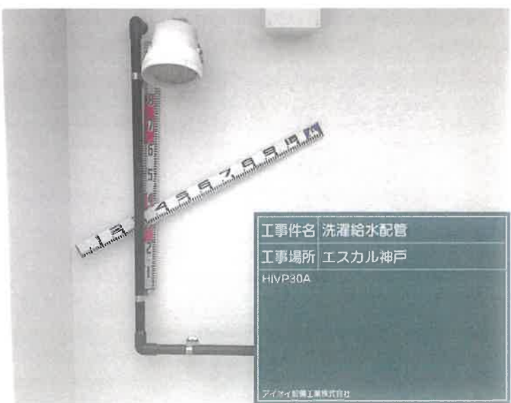
【工事種目】エスカル神戸洗濯給水配管 【施工内容1】屋上外部 【施工内容2】支持金具取付
