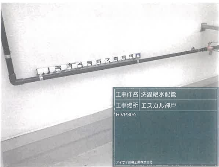
【工事種目】エスカル神戸洗濯給水配管 【施工内容1】屋上外部 【施工内容2】支持金具取付
