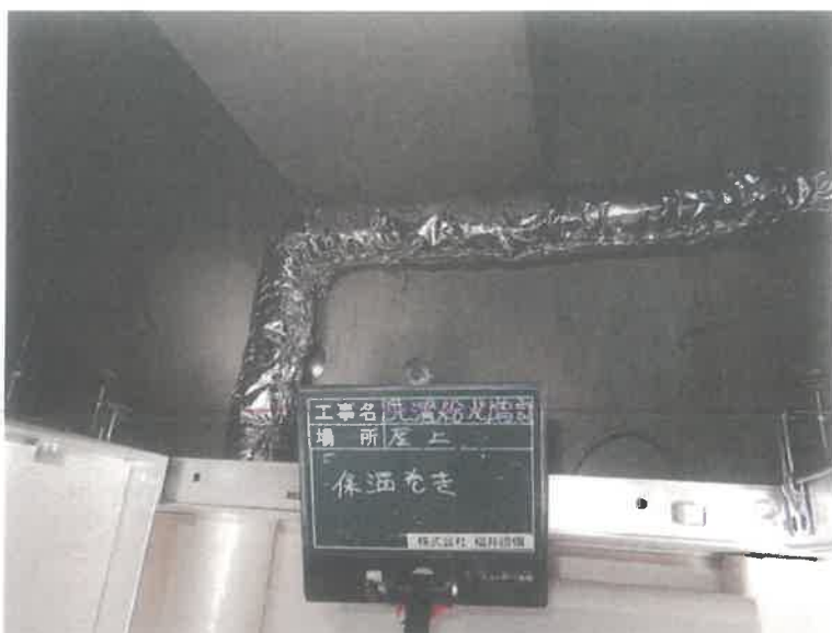
【工事種目】エスカル神戸洗濯給水配管 【施工内容1】5階洗濯室 【施工内容2】室内天井隠蔽部 【施工内容3】グラスウール保温帯/きつ甲金網
