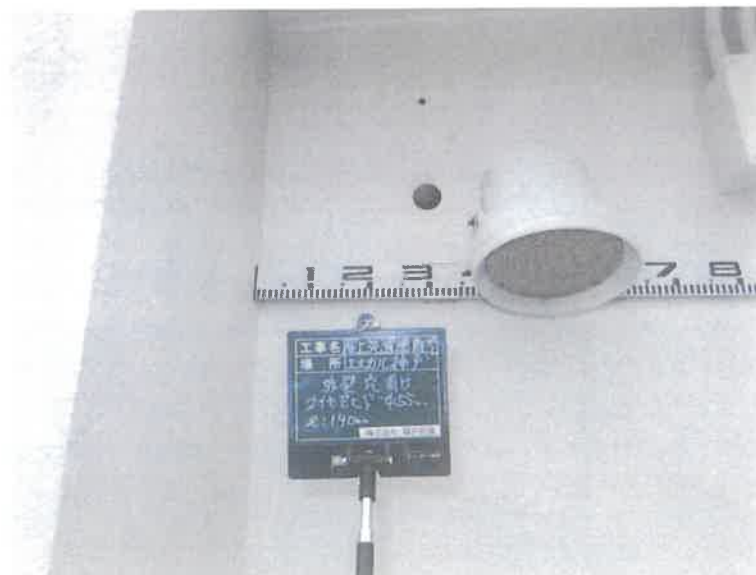
【工事種目】エスカル神戸洗濯給水配管 【施工内容1】屋上外部 【施工内容2】外壁ダイヤモンド貫通 【施工内容3】55mm貫通
