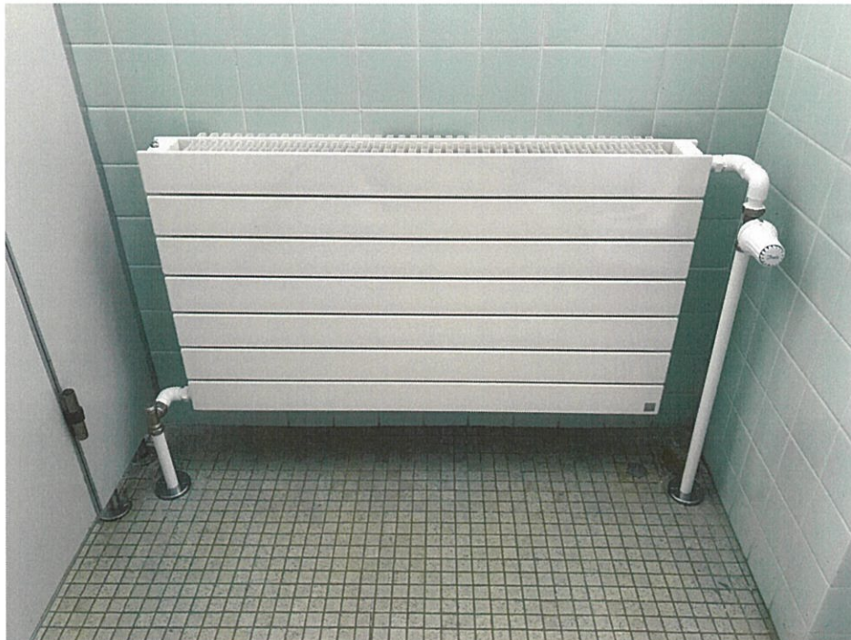
1階男子便所 PH-3 温水パネルヒーター
