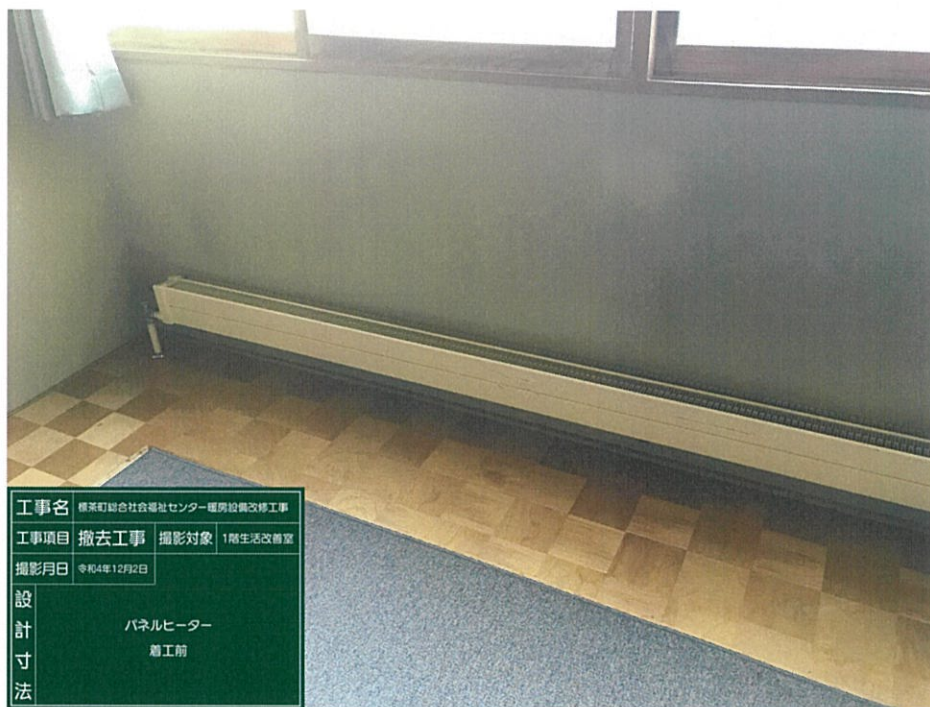
1階生活改善室 温水パネルヒーター
