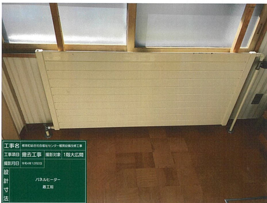
1階大広間 温水パネルヒーター
