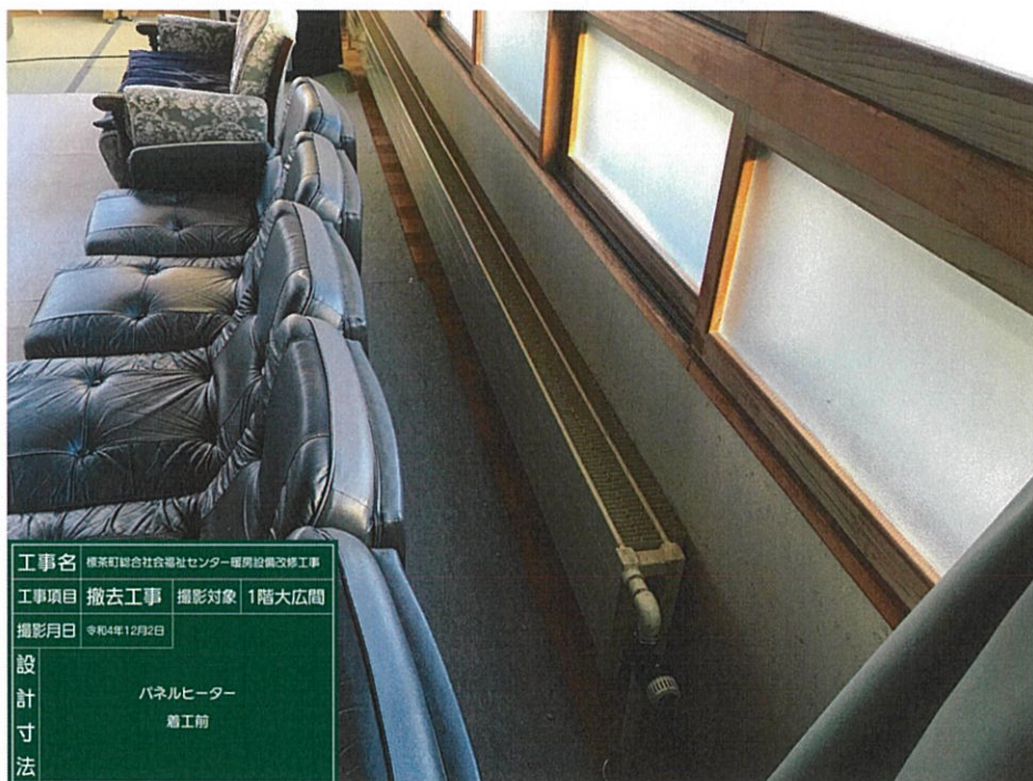
1階大広間 温水パネルヒーター
