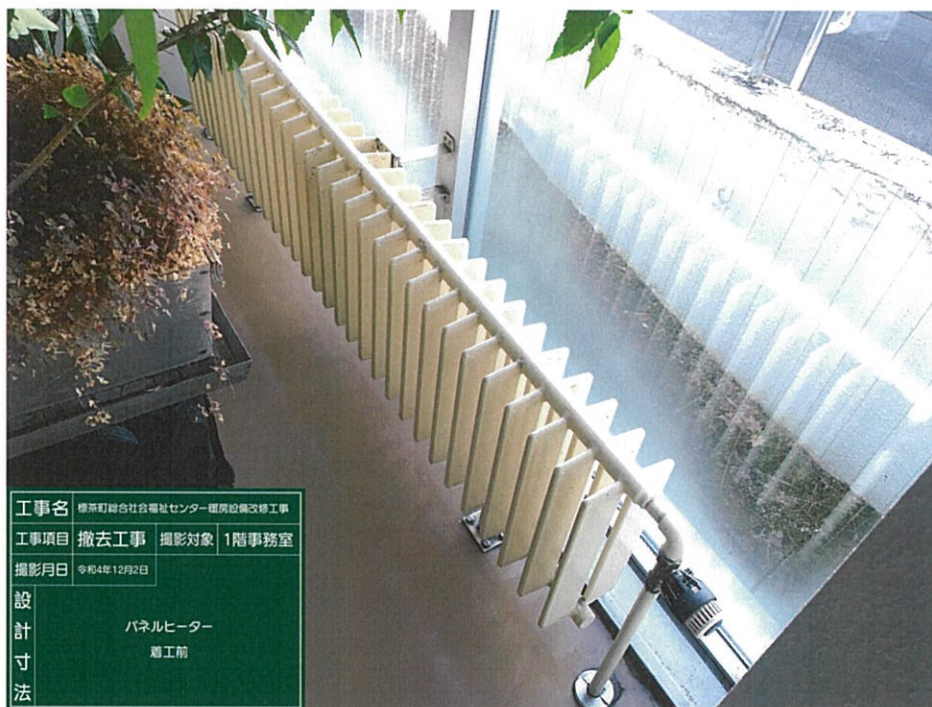
1階事務室 温水パネルヒーター
