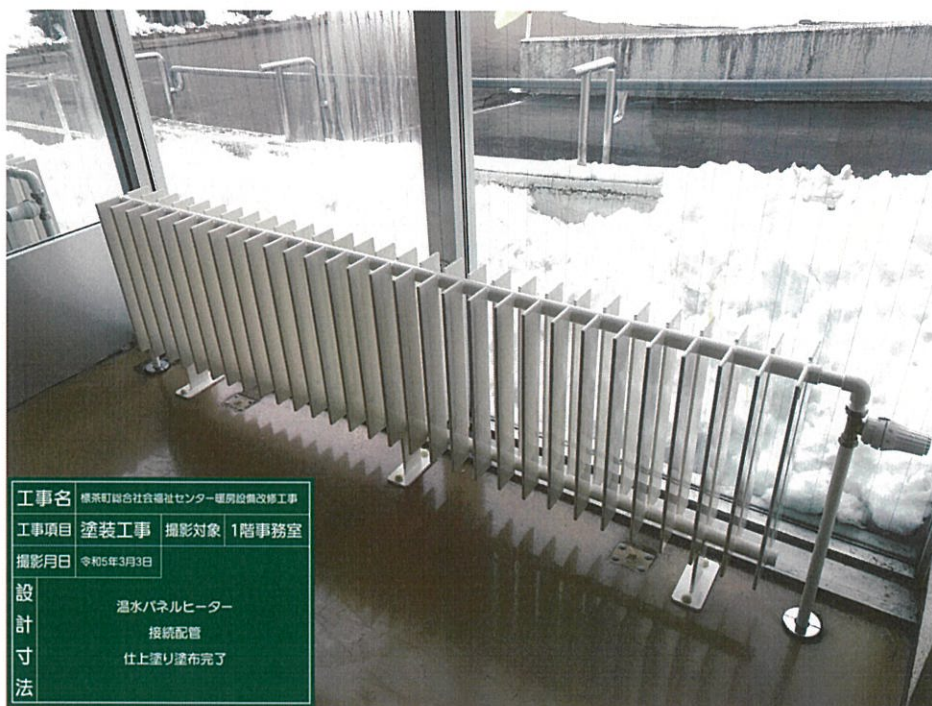
1階事務室 PH-9 温水パネルヒーター
