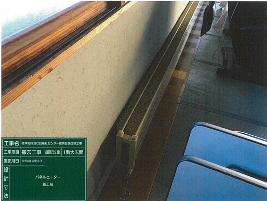
1階大広間 温水パネルヒーター
