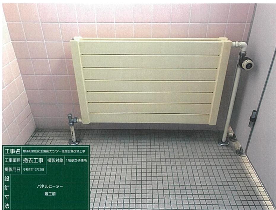
1階女子便所 温水パネルヒーター
