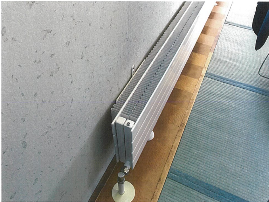
1階大広間 PH-7 温水パネルヒーター
