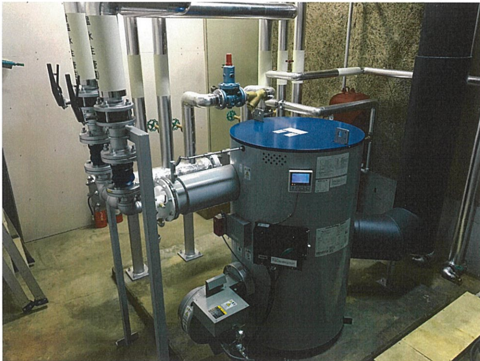
ボイラー室 BH-1 ボイラー
