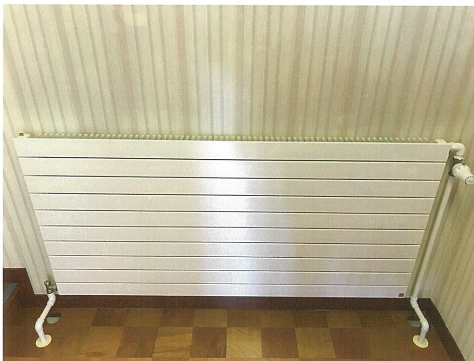
1階大広間 PH-6 温水パネルヒーター
