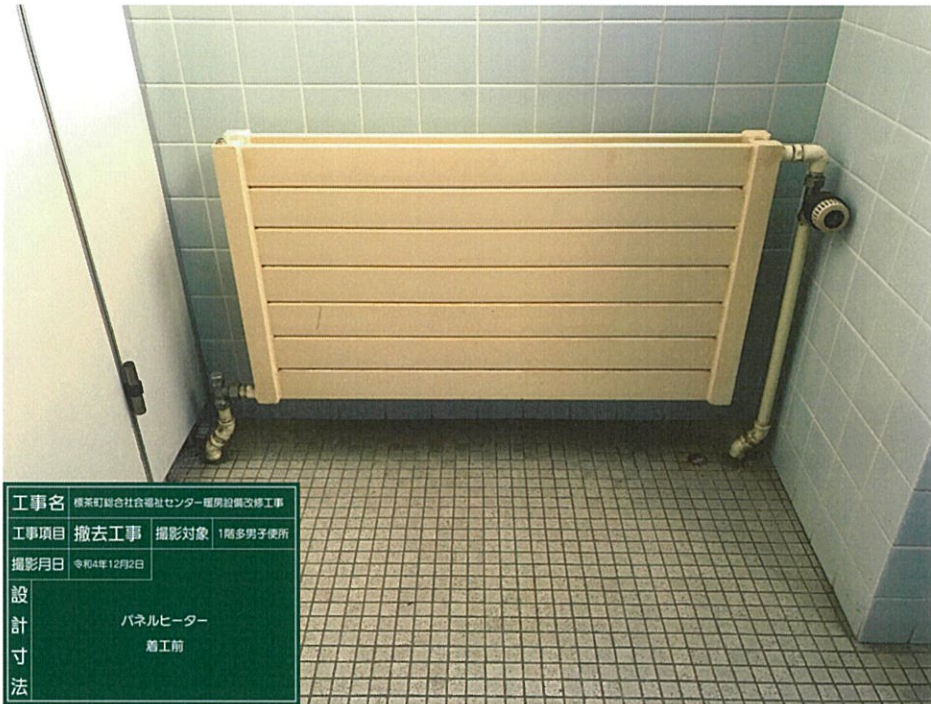
1階男子便所 温水パネルヒーター
