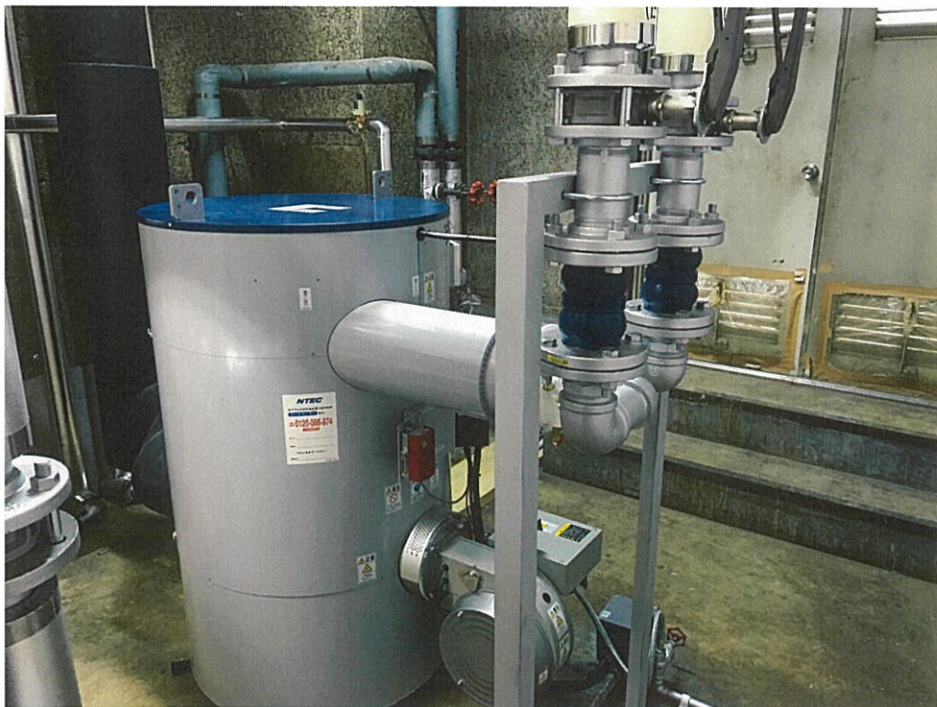
ボイラー室 BH-1 ボイラー
