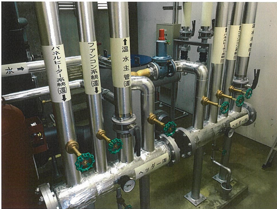
ボイラー室 ヘッダー
