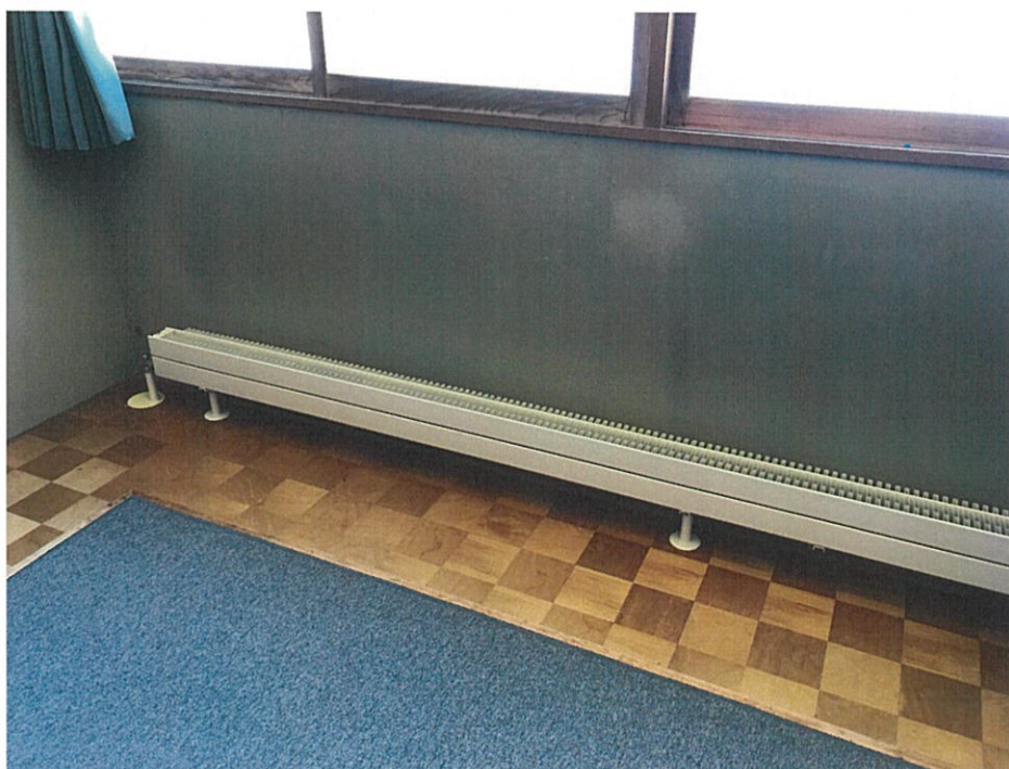
1階生活改善室 PH-5 温水パネルヒーター
