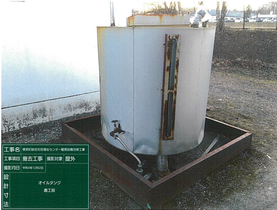
屋外 オイルタンク
