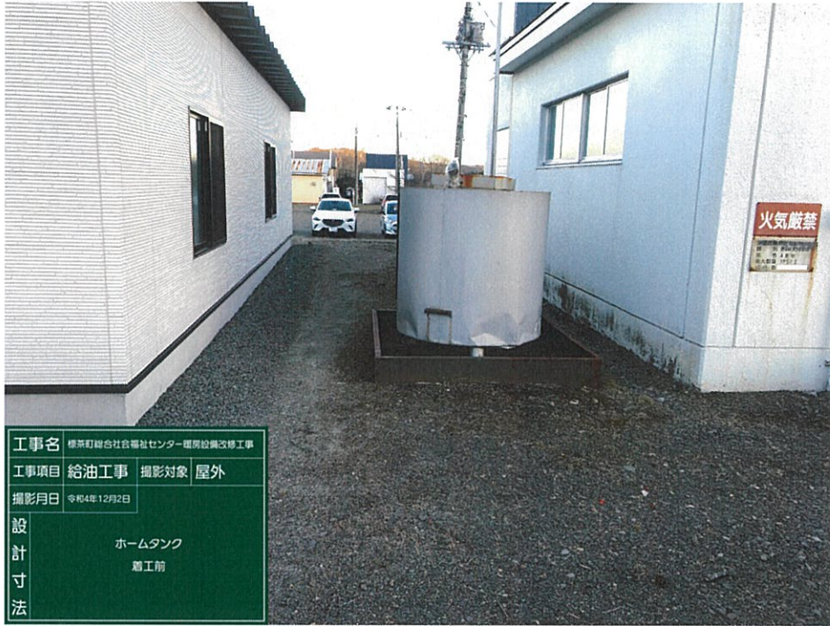
屋外 ホームタンク
