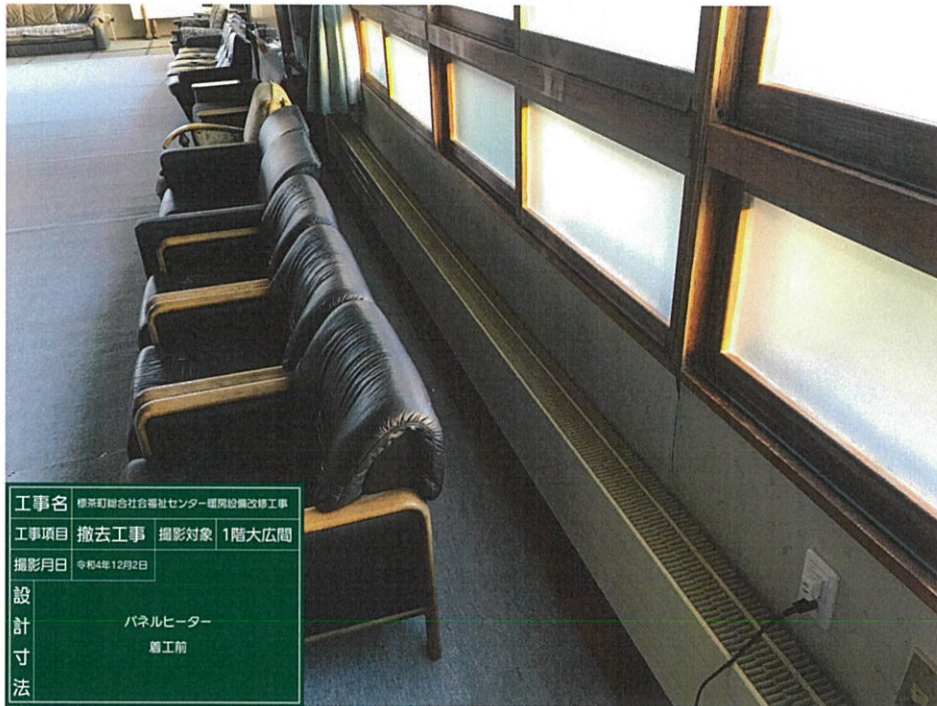
1階大広間 温水パネルヒーター
