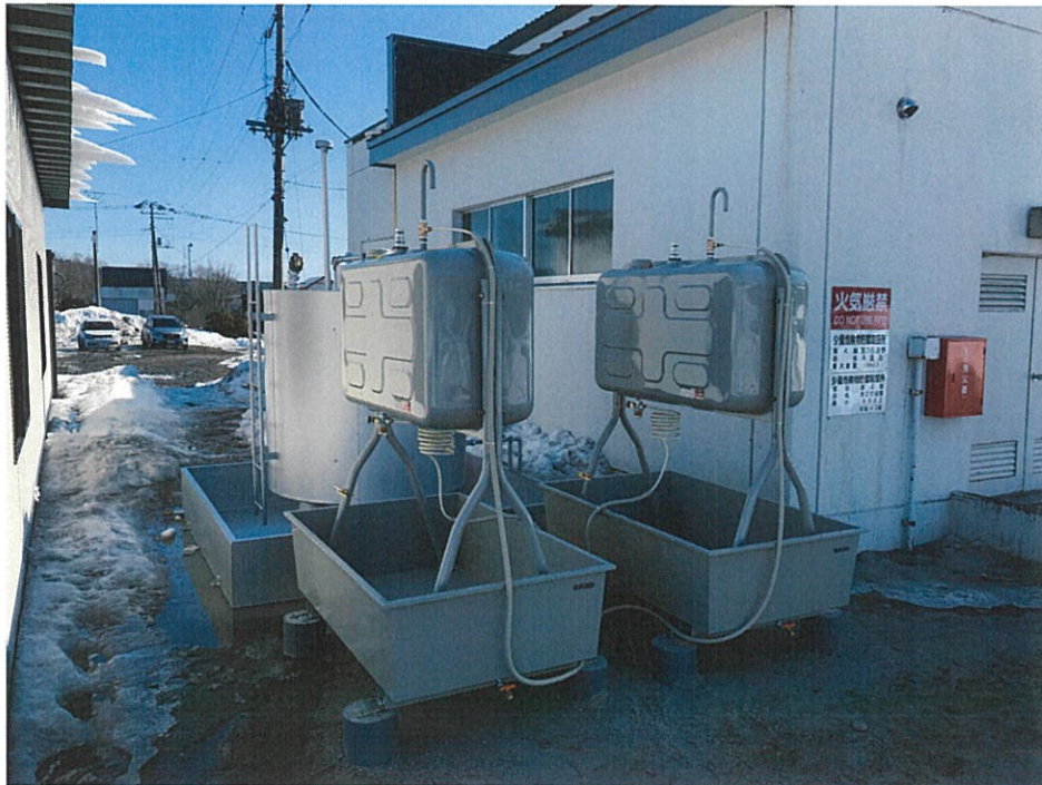
屋外 ホームタンク
