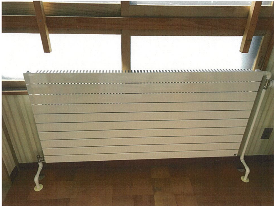
1階大広間 PH-6 温水パネルヒーター
