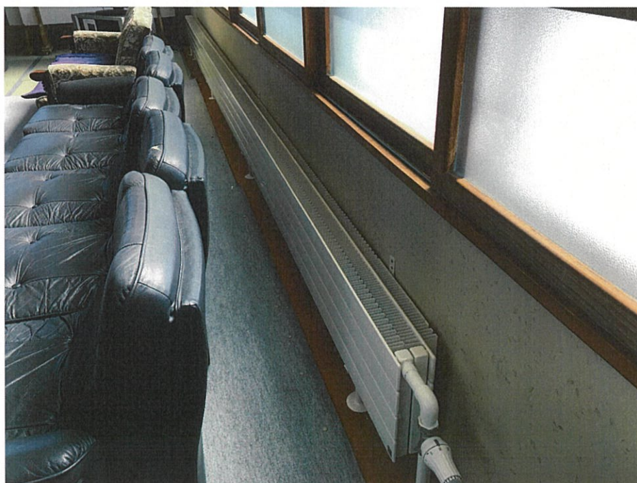
1階大広間 PH-7 温水パネルヒーター
