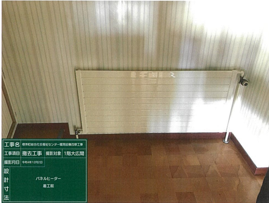
1階大広間 温水パネルヒーター
