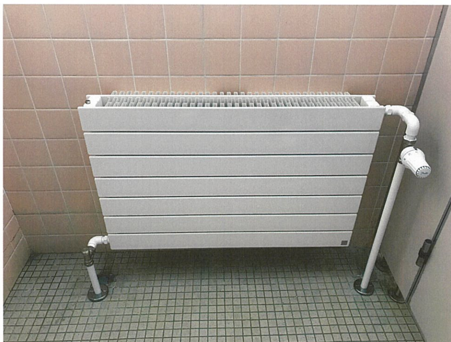
1階女子便所 PH-4 温水パネルヒーター
