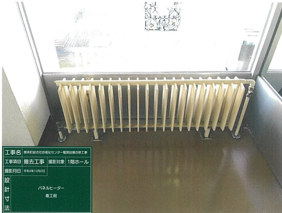
1階事務室 温水パネルヒーター
