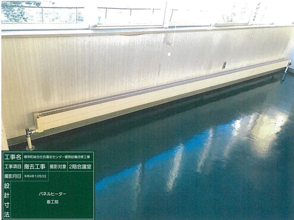
2階会議室 温水パネルヒーター
