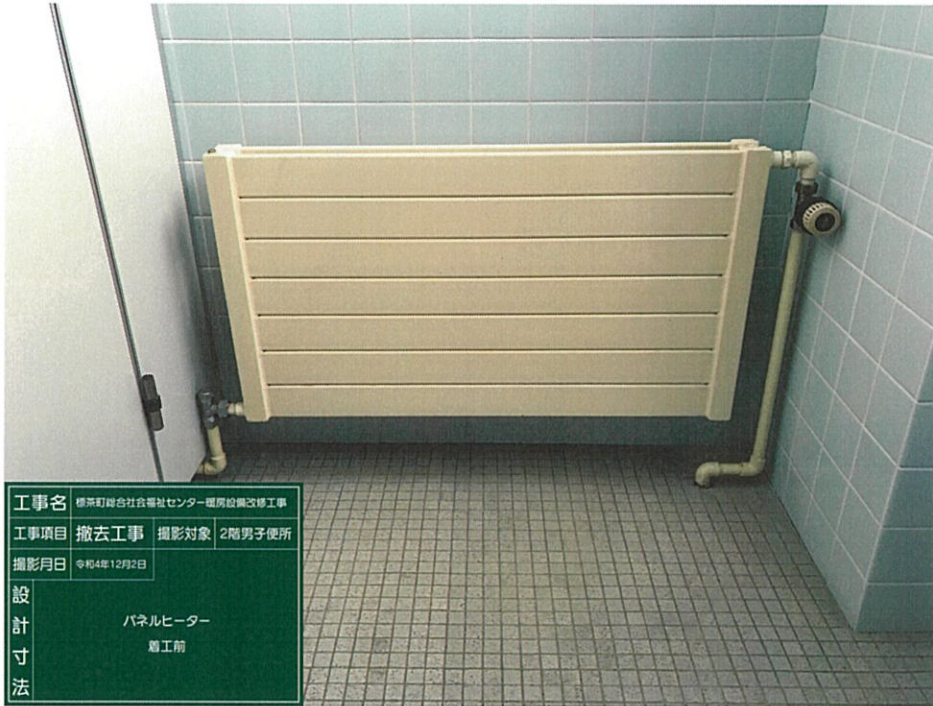
2階男子便所 温水パネルヒーター
