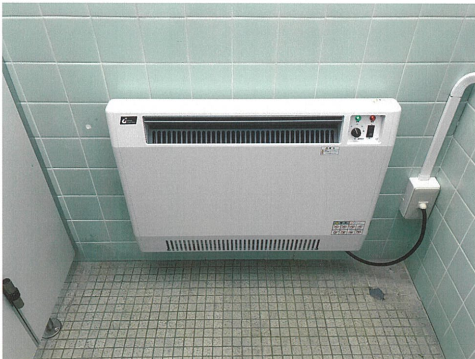
2階男子便所 EH-1 電気パネルヒーター
