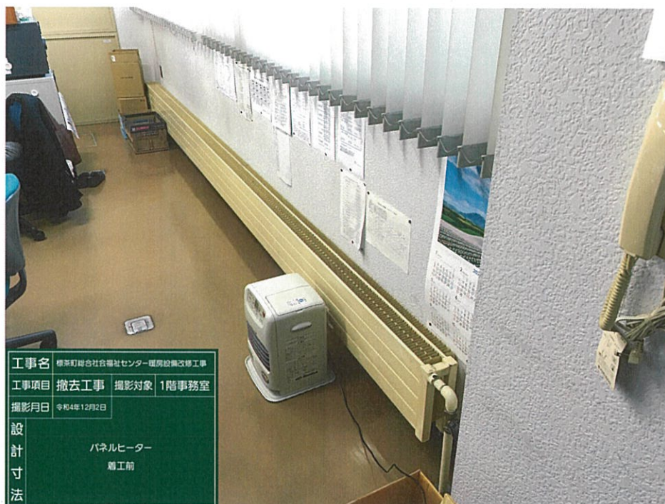
1階事務室 温水パネルヒーター
