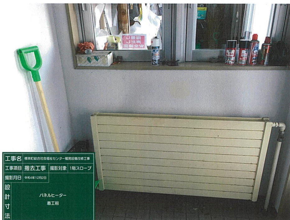
1階スロープ 温水パネルヒーター
