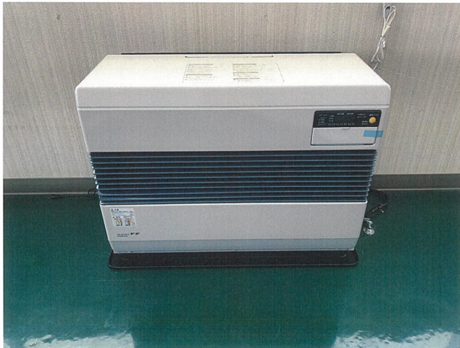
2階図書室 FF-1 FF式温風暖房機
