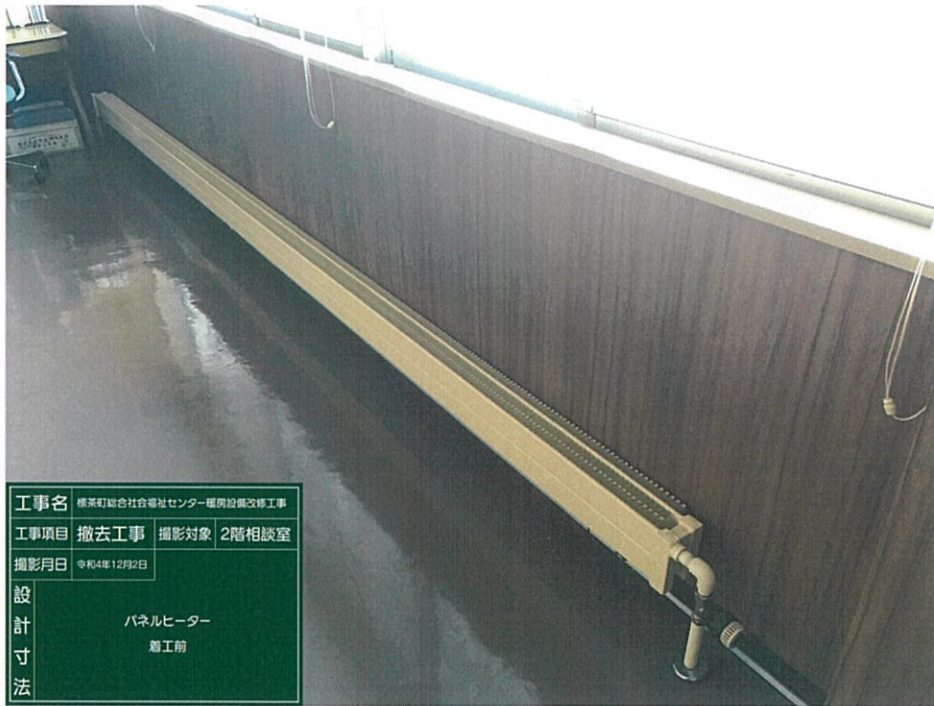
2階相談室 温水パネルヒーター
