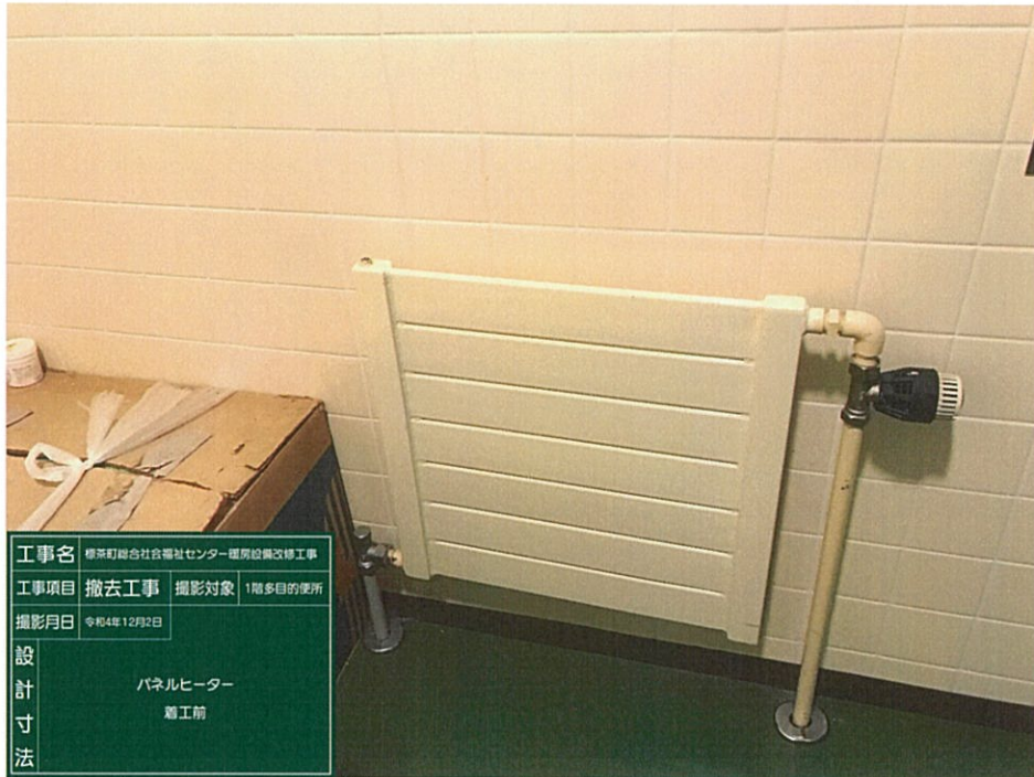
1階多目的便所 温水パネルヒーター
