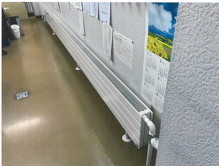
1階事務室 PH-11 温水パネルヒーター
