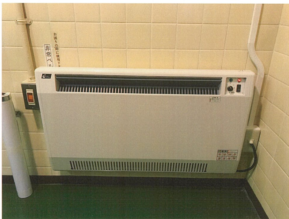
2階多目的便所 EH-2 電気パネルヒーター
