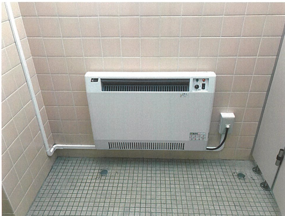
2階女子便所 EH-1 電気パネルヒーター
