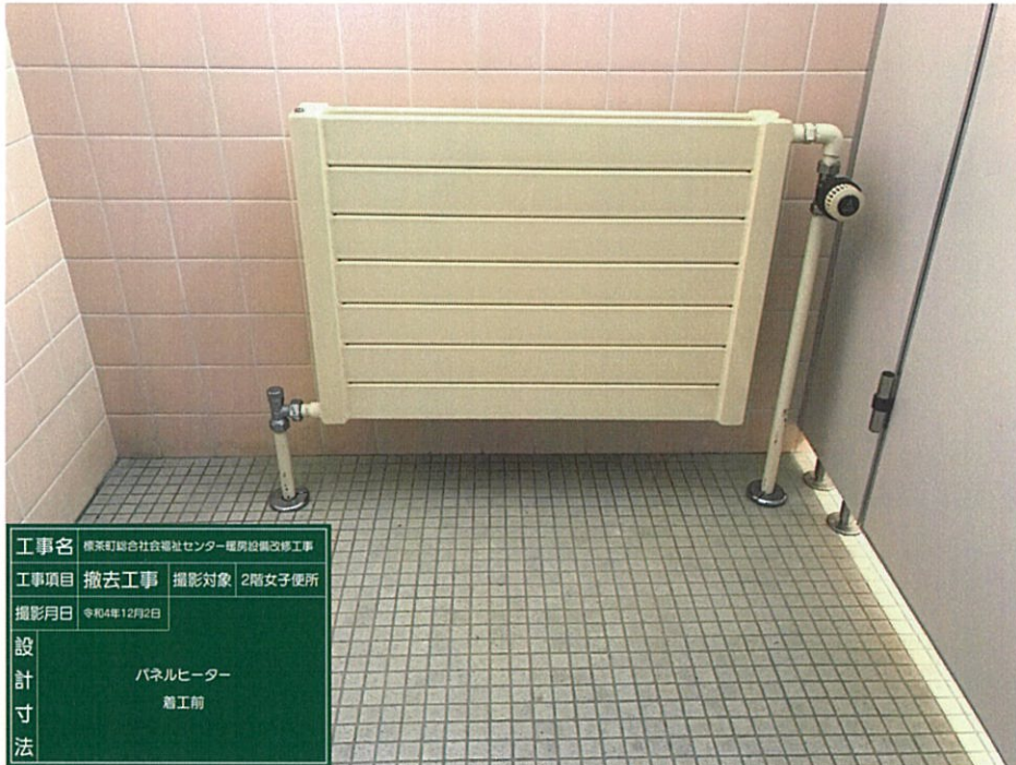
2階女子便所 温水パネルヒーター
