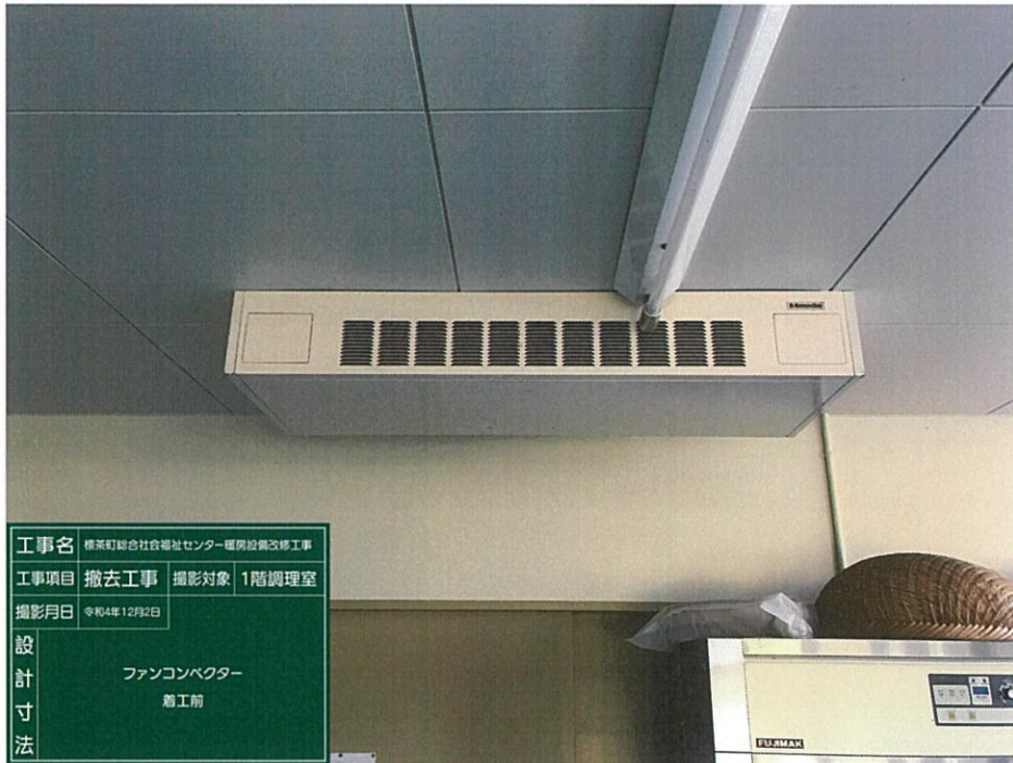
1階調理室 ファンコンベクター
