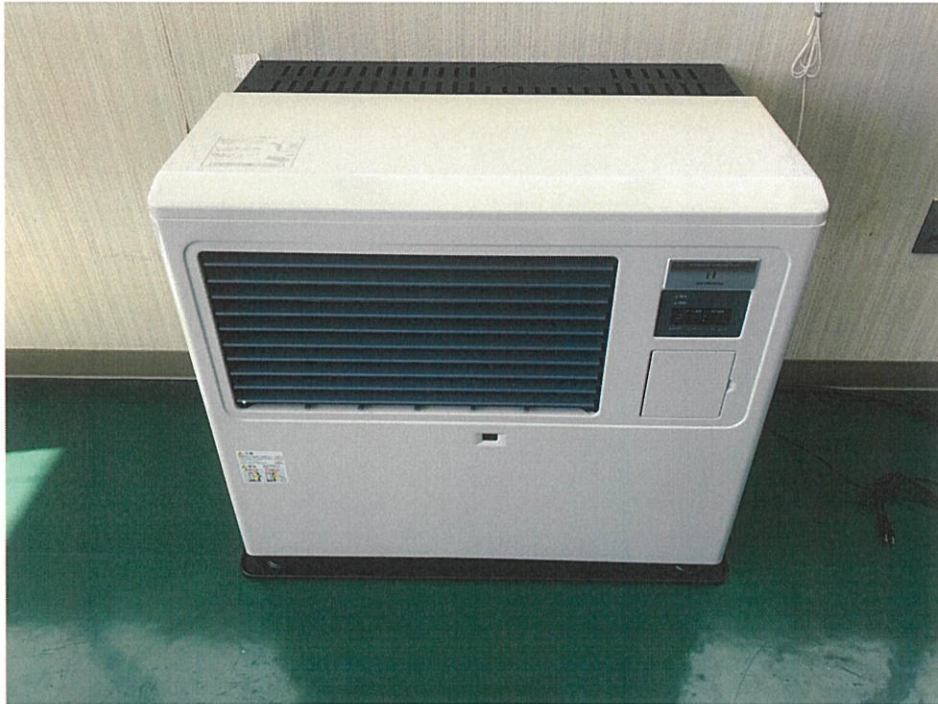
2階会議室 FF-5 FF式温風暖房機
