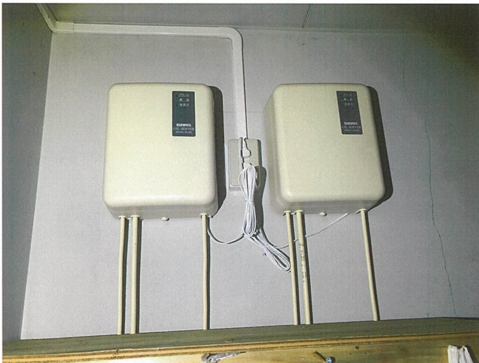
2階掃除用具入 オイルサーバー
