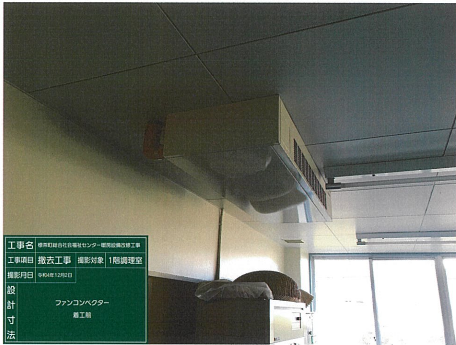
1階調理室 ファンコンベクター
