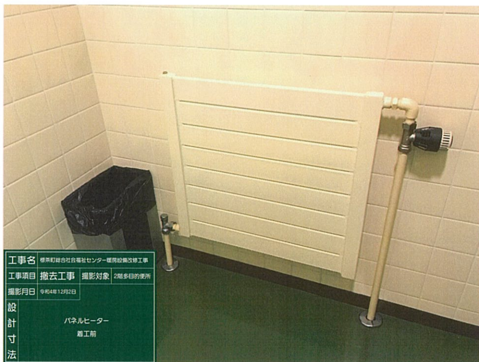
2階多目的便所 温水パネルヒーター
