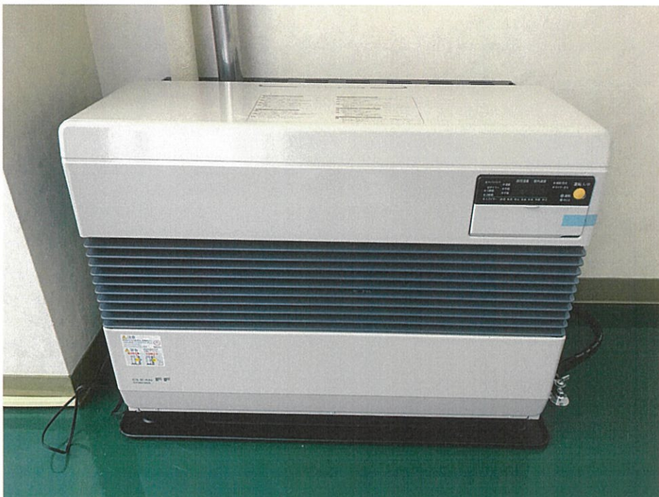
2階事務室2 FF-3 FF式温水パネルヒーター
