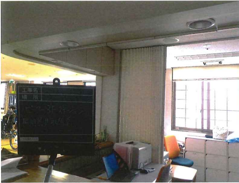
【工事種目】竣工前後 【施工内容1】ピーター3F ステーション 【施工内容2】照明器具取替前
