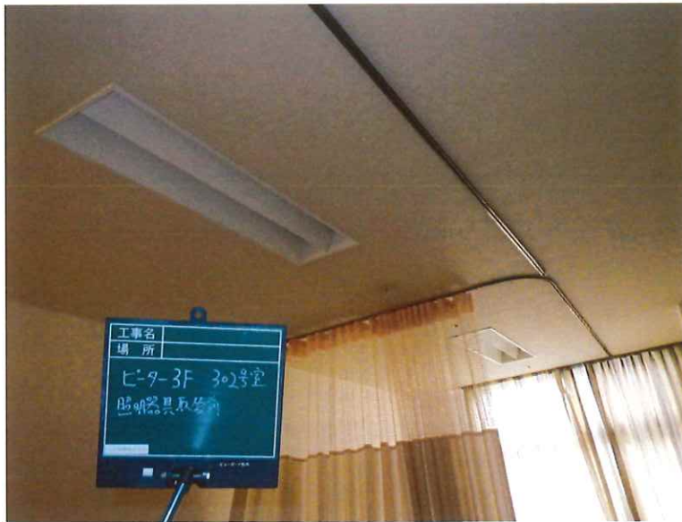
【工事種目】竣工前後 【施工内容1】ピーター3F 居室302 【施工内容2】照明器具取替前
