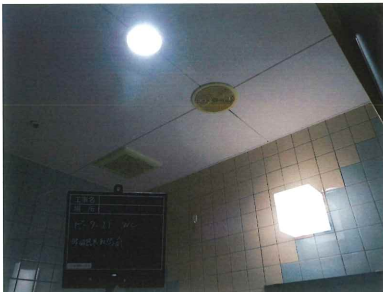
【工事種目】竣工前後 【施工内容1】ピーター-2F WC 【施工内容2】照明器具取替前
