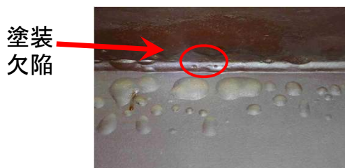
塗装欠陥近傍に発生した陰極剥離によるブリストア
