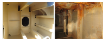
作業後の塗装状態(左)と塗装不良による錆(右)
