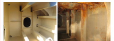
作業後の塗装状態（左）と塗装不良による錆（右）
