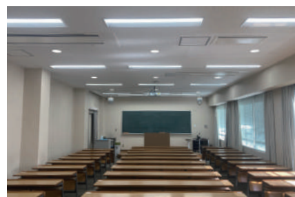
改修後（LED照明）
