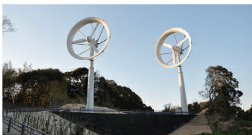
70kW×2 風レンズ型風力発電設備
