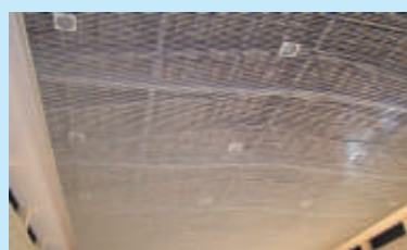
アリーナ LED 照明 (改修前)
