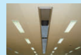
トレーニングルーム暖房 (改修前)
