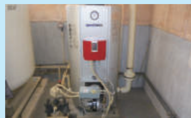
ボイラー (改修後)
