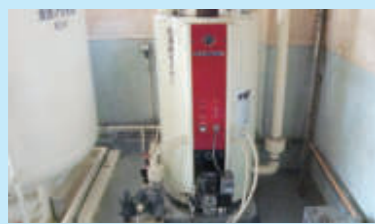
ボイラー (改修前)
