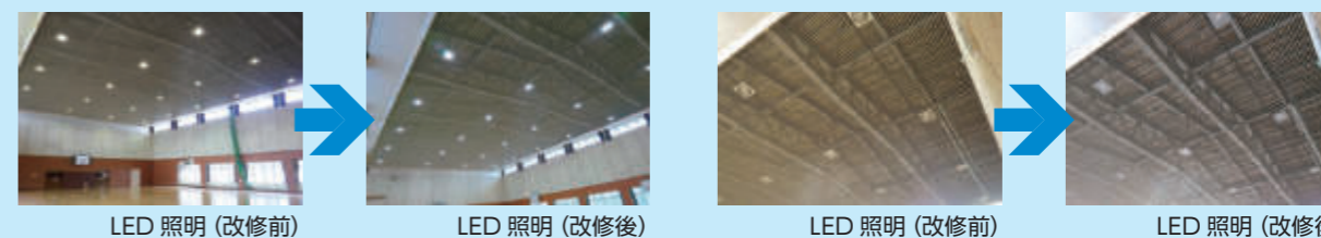
LED 照明 (改修前)
