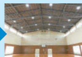
LED 照明 (改修後)
