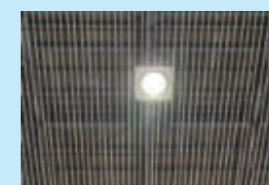
LED 照明 (改修前)
