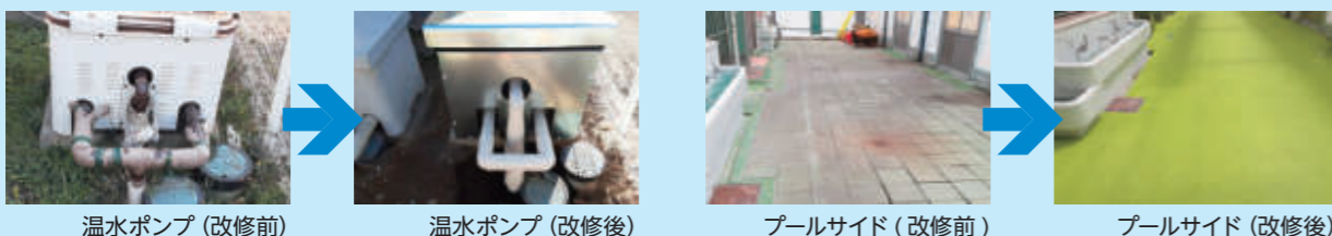
温水ポンプ (改修前)
