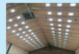
LED 照明 (改修前)
