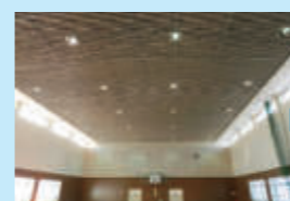
LED 照明 (改修前)
