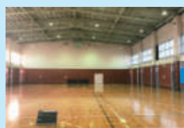
LED 照明 (改修前)
