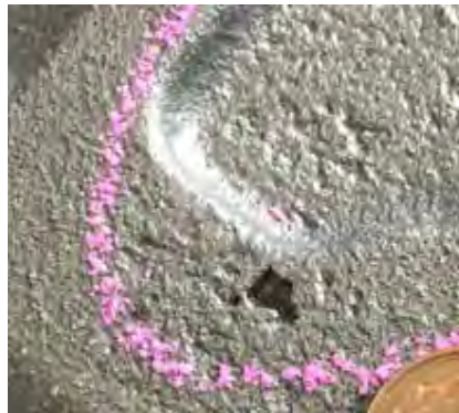
図 3.2-3 欠陥（砂カミ）を見つけた例（シナリオ1）
