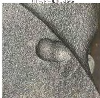
ブローホール④.JPG
