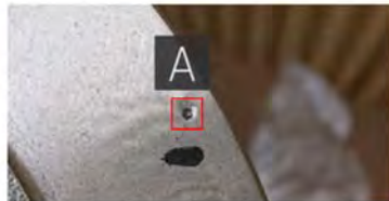
Test05 (正解:ピンホール)
