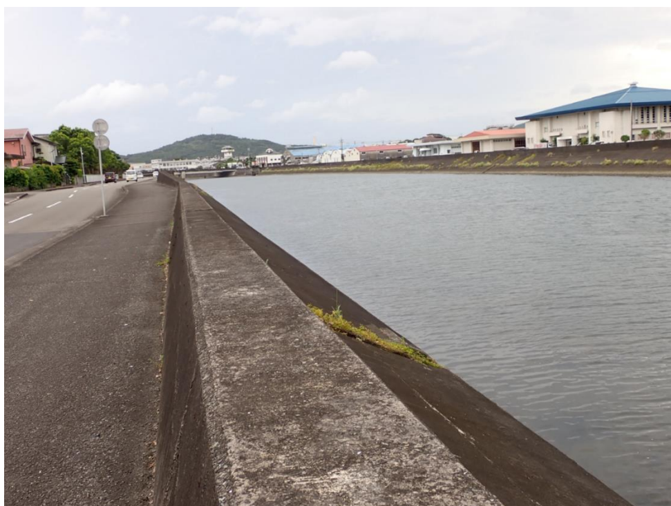
写真-3.5 花渡川（写真左が桜木町、写真奥が下流方向（2022年7月29日17時09分）
