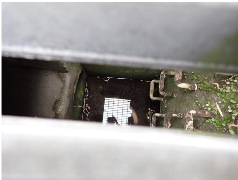
写真-3.4 花渡川沿い道路脇の下水溝の様子（上蓋から下方、2022年7月29日17時08分）
