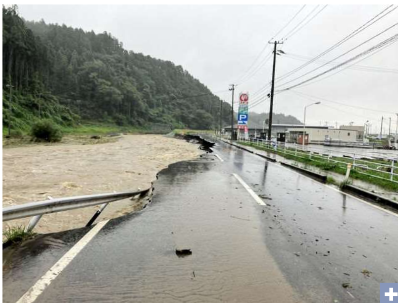
八幡川の水位上昇により陥没した国道398号=16日午前8時すぎ、宮城県南三陸町志津川御前下(県気仙沼土木事務所提供)
