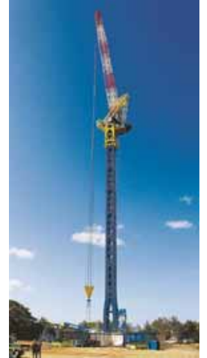
風車建設用タワークレーン(江差風力発電所) ( https://www.kensetsunews.com/archives/746577 より引用)
