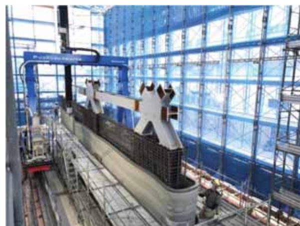
北川鉄工所が協力して製作した建設3Dプリンター 外周約42mの型枠1層を約10分で印刷
