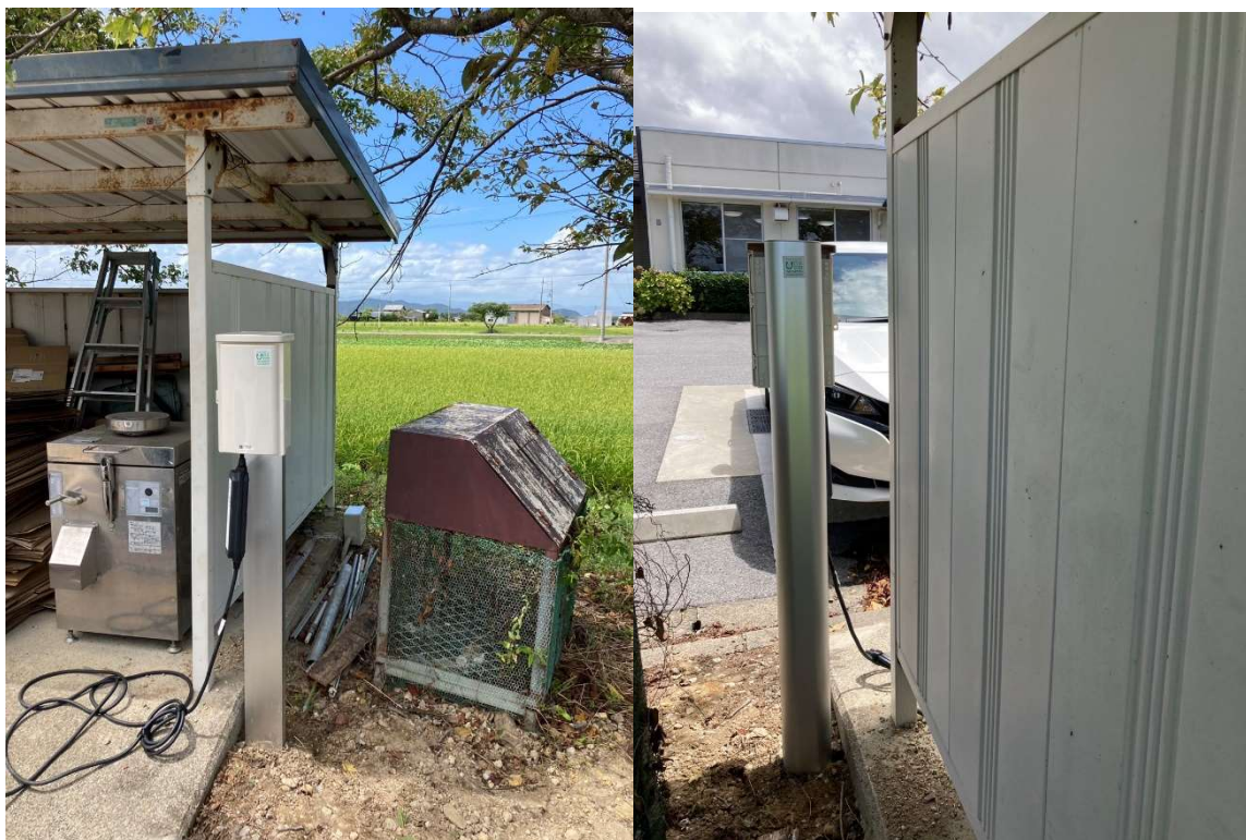
◎EV車の充電スタンド
