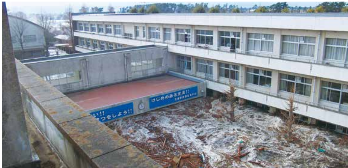
津波にのまれた校舎
