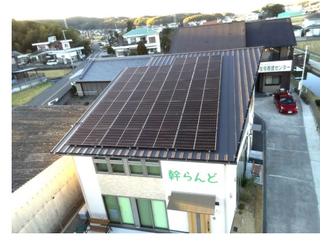
太陽光パネル
