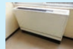
ミーティングルーム冷暖房 (改修前)
