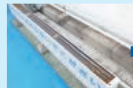
暖房設備 (改修前)
