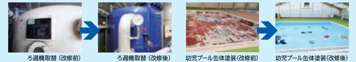
ろ過機取替(改修前) ろ過機取替(改修後) 幼児プール缶体塗装(改修前) 幼児プール缶体塗装(改修後)
