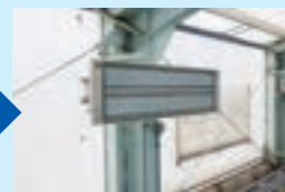
暖房設備 (改修後)
