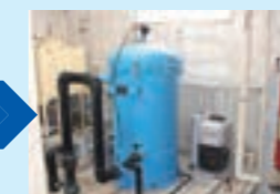
ろ過機 (改修後)
