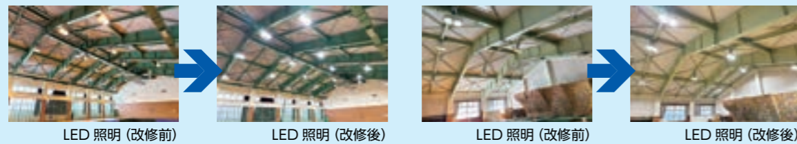
LED照明(改修前) LED照明(改修後) LED照明(改修前) LED照明(改修後)
