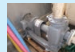
ポンプ (改修前)
