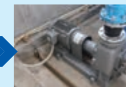
ポンプ (改修後)
