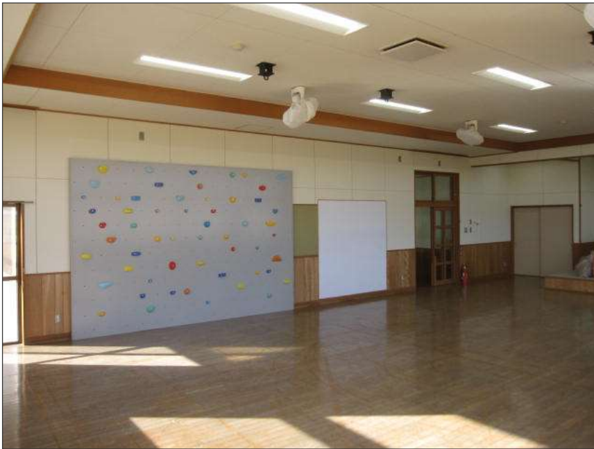
令和5年西外城田内部・外壁 改修工事 完成 プレイルーム
