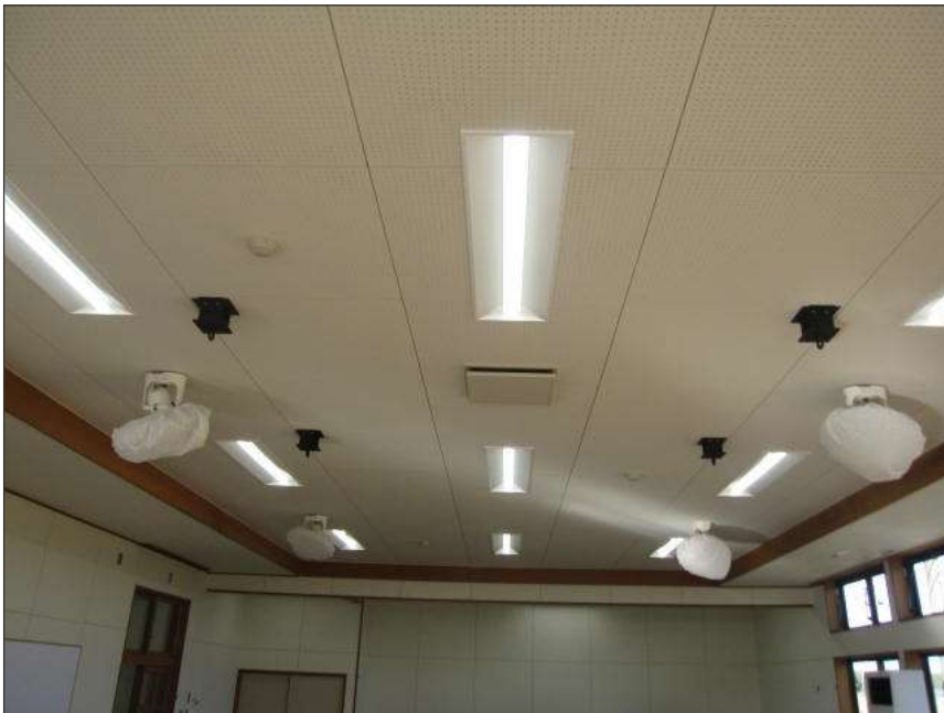
令和5年西外城田内部・外壁 改修工事 完成 プレイルーム
