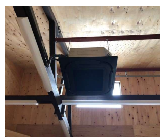
天井エアコン2台・LEDライト
