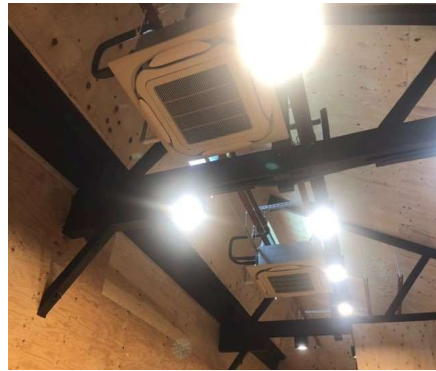
天井エアコン・LED照明
