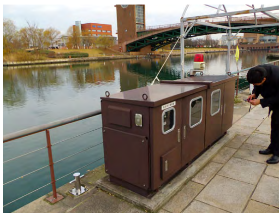
(b) 陸電設備
