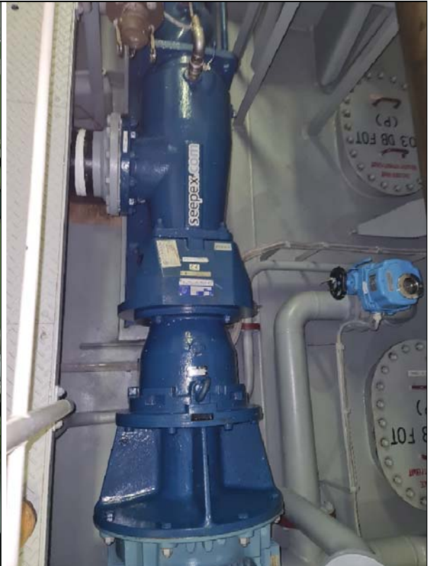
汚泥用ポンプ
