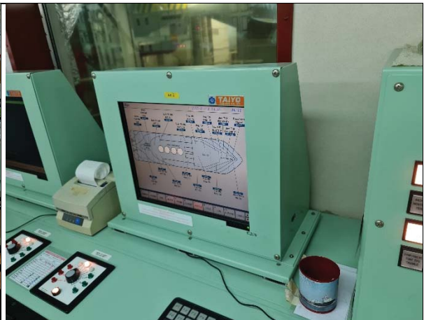
機関制御操作パネル
