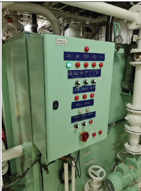
汚水処理装置
