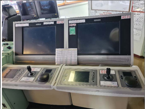
GE (旧 Converteam) 船位保持システム・コンソール
