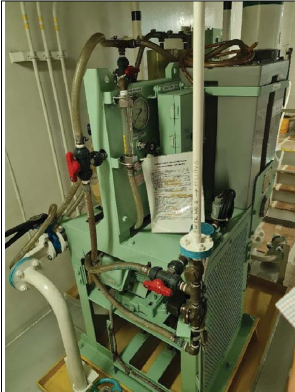
逆浸透式海水炭水化装置
