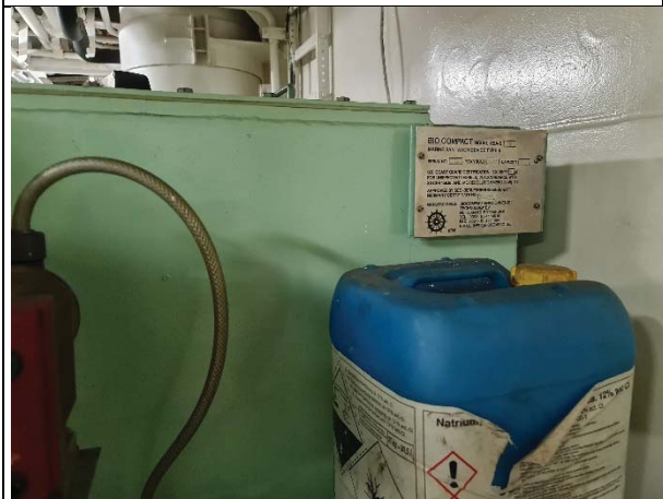
汚水処理装置
