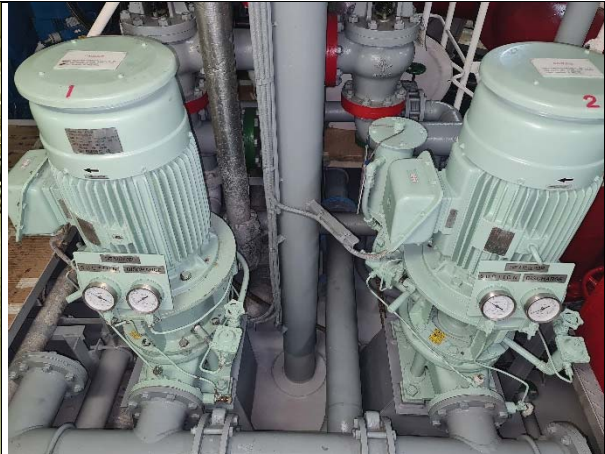
衛生及びビルジ・ポンプ 消火及びビルジ・ポンプ
