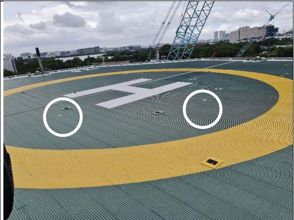
ヘリデッキ統合消火システム
