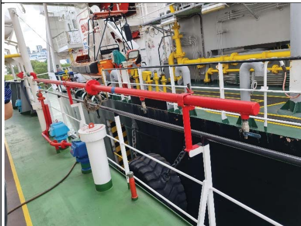
他船消火ウォーターカーテン・スプレー
