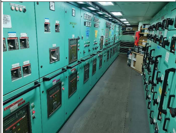
主配電盤及び給電盤
