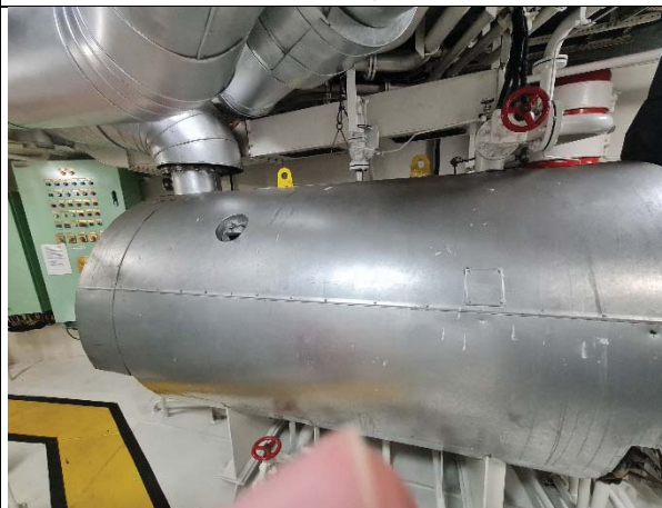
マッド・タンクの温水ボイラー
