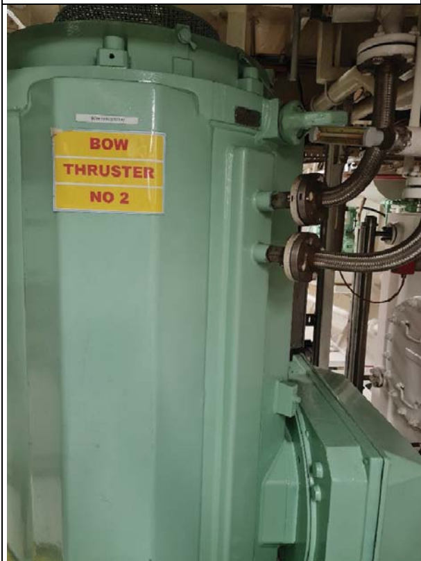
バウ・スラスター・エンジン・モーター
