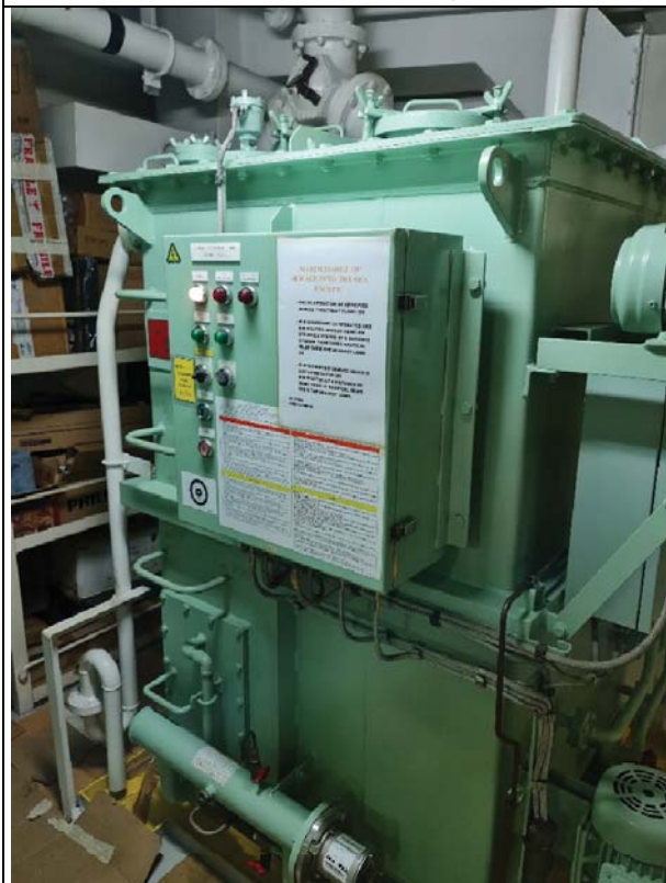
污水处理装置
