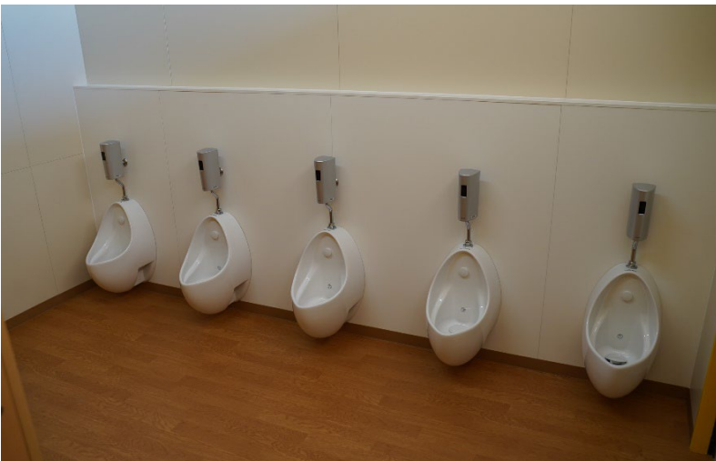
1階東側トイレ（小便器）
