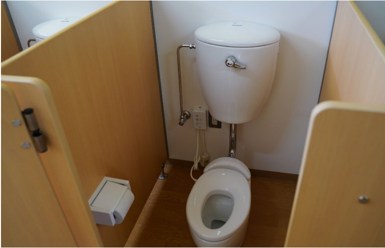
1階東側トイレ（大便器）
