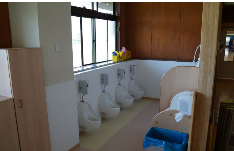
1階西側トイレ（小便器）
